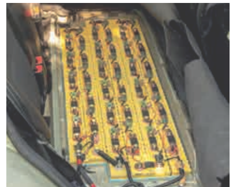
Áreas de almacenamiento de baterías grandes y/o desatendidas
