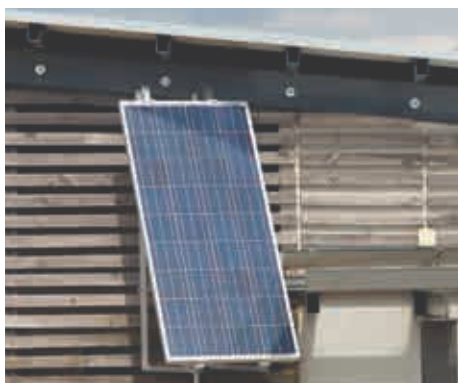
Thuisaccu's voor de opslag van zonne-energie (capaciteit 4-5 kWh)
